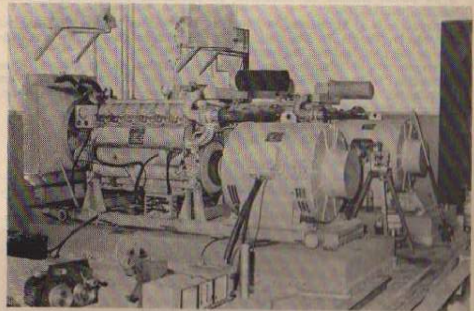
La foto muestra los nuevos equipos electrógenos de la Unidad 1, Olmos.
