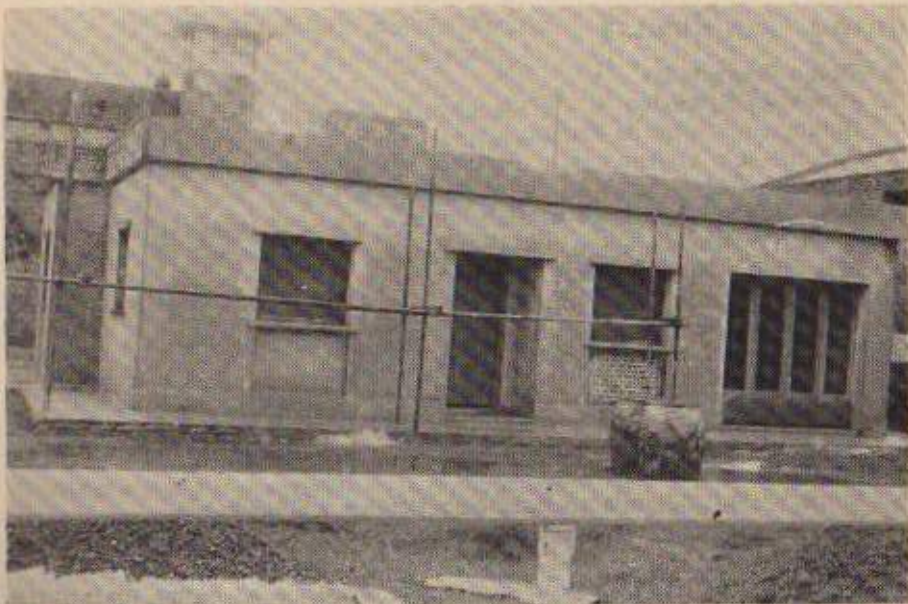
Obra de construcción en una casa destinada al personal de la Unidad 3, San Nicolás
